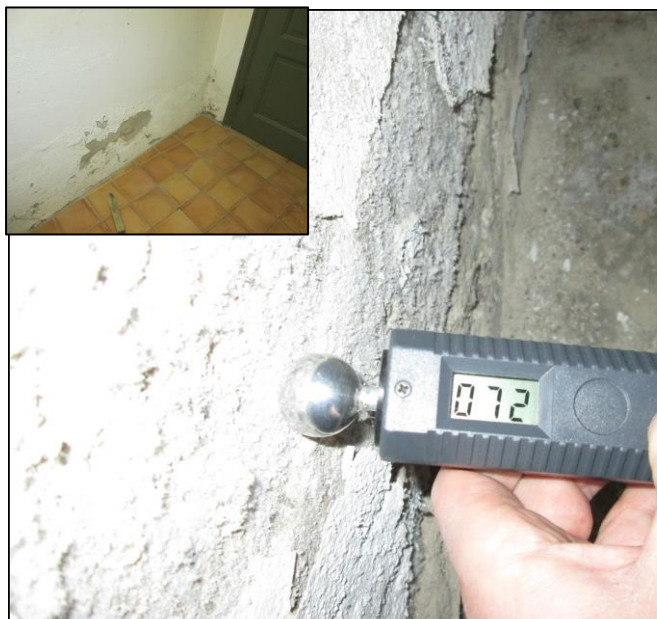
Putssläpp i källare samt fuktmätning
