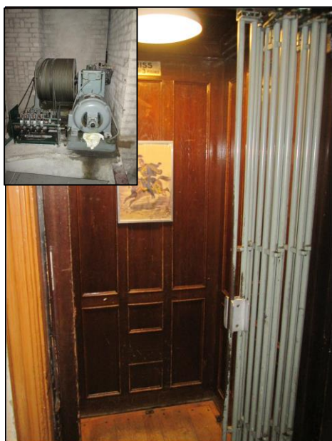
Äldre typer av hissar i trapphus
