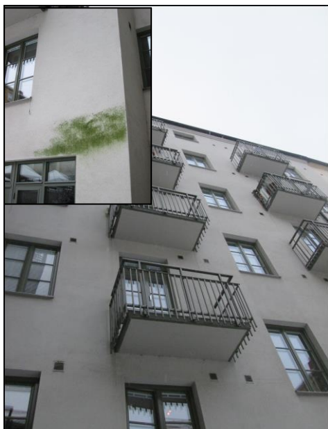
Påhängda balkonger mot gården samt algpåväxt
