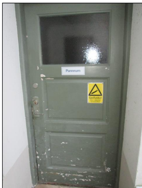
Trädörr med färgskador
