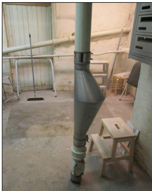
Relinade spillvattenstammar med råttstopp
